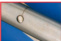
Волосяная трещина в области шарнира ножниц
